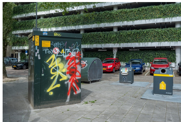
Afbeelding: Transformatorhuisje (IABR)
